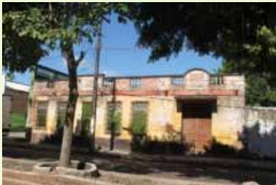
Edificação em ruína datada de 1940, com a inscrição no frontão, onde funcionava a Farmácia da família Alvim.
