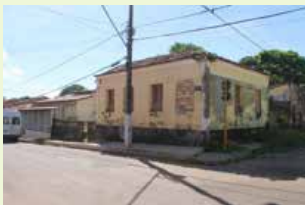
Edificação de um pavimento em processo de arruinamento.
