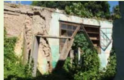
Interior da edificação em ruína.
