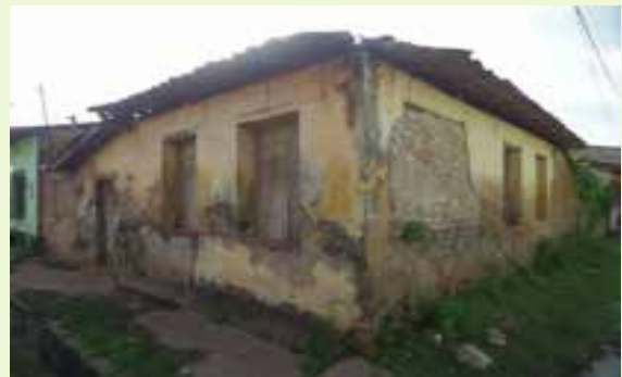
Edificação de um pavimento em processo de arruinação
