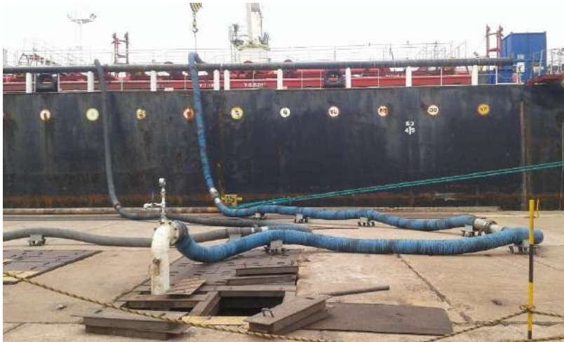
Figura 5. Acoplamento de mangotes entre navio e tomadas de recebimento interligadas ao sistema de tubovias do terminal
