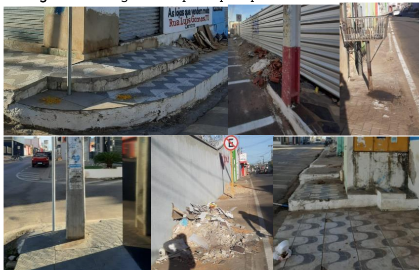
Figura 16: Imagens dos principais problemas encontrados.
