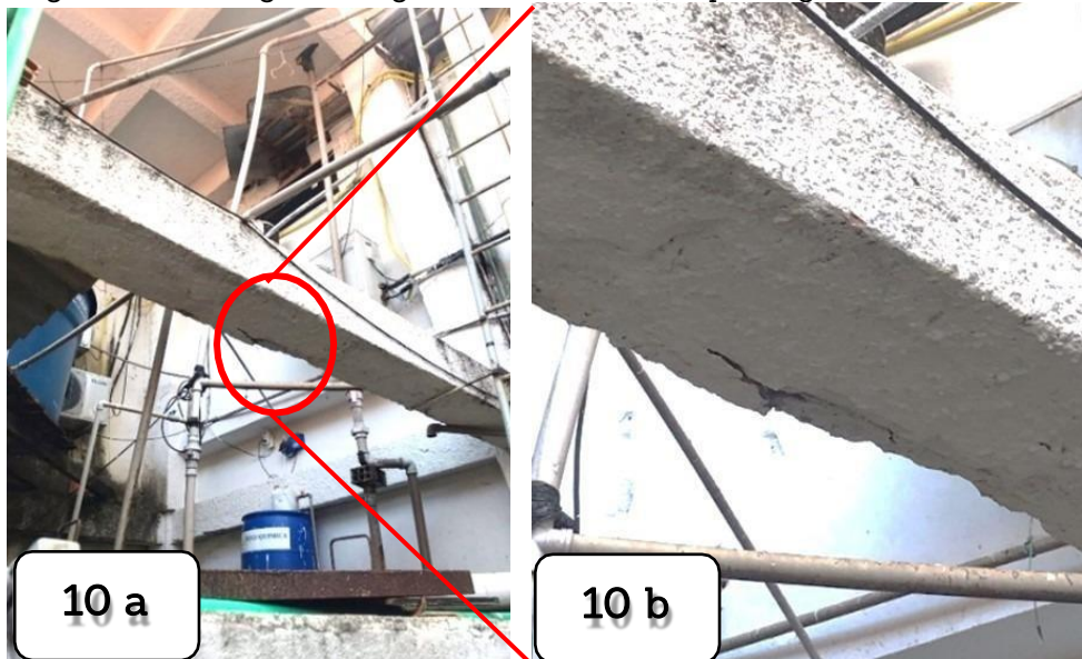
Figura 10: Viga da caixa d'água, a: Viga com manifestação patológica, b: Abertura da rachadura.
