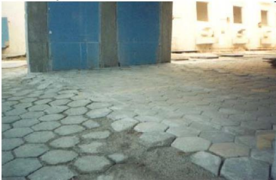
Figura 4: Recalque no piso do estacionamento.
