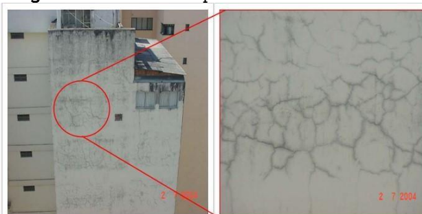
Figura 3: Fissuras mapeadas ou disseminadas.
