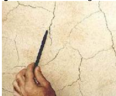
Figura 1: Fissura em argamassa.
