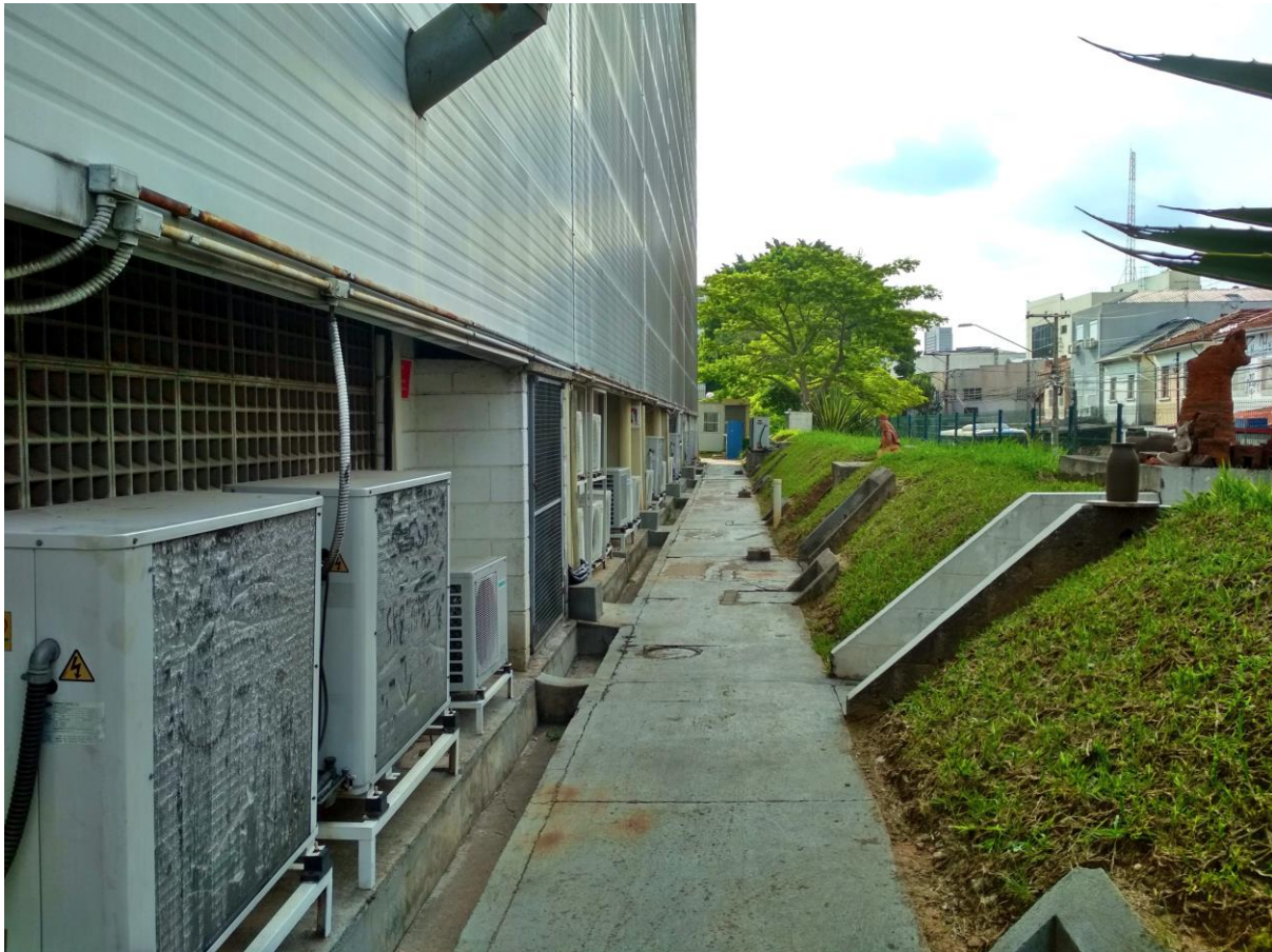
Figura 7 - Um corredor do Instituto de Artes, com suas várias unidades condensadoras de ar-condicionado
